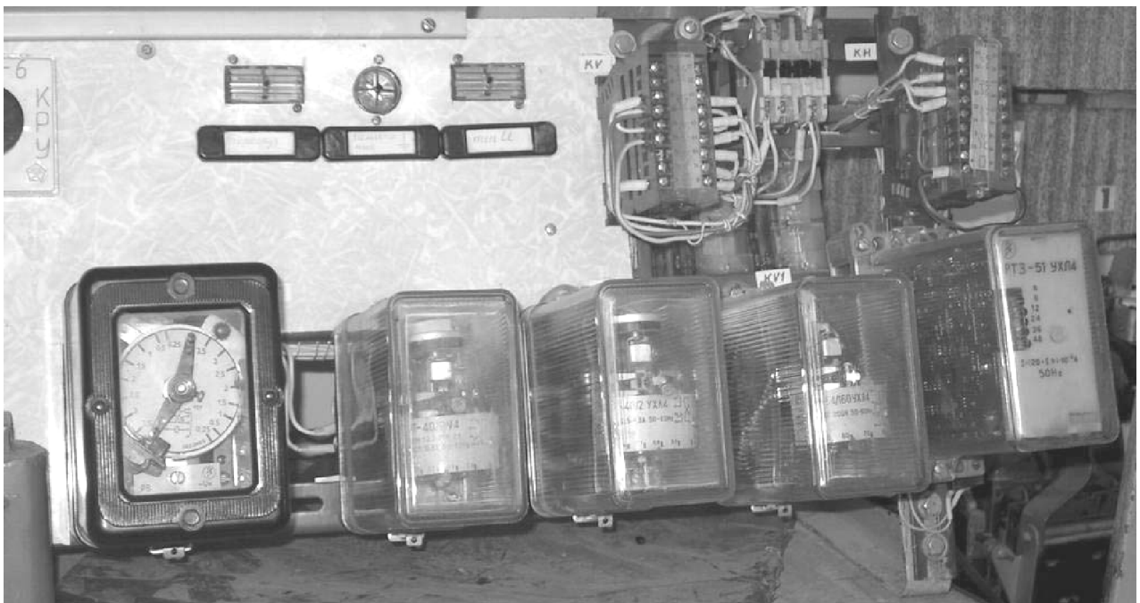
Рисунок 17 - Вид сборки из реле времени, тока, напряжения, земляной защиты и сигнальных реле.
