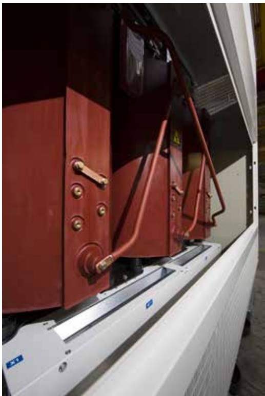
Трансформатор с принудительной вентиляцией в кожухе (класс защиты IP 31)
