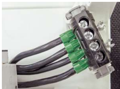
Дополнительная изолированная шинка, установленная в специально предусмотренном месте щита
